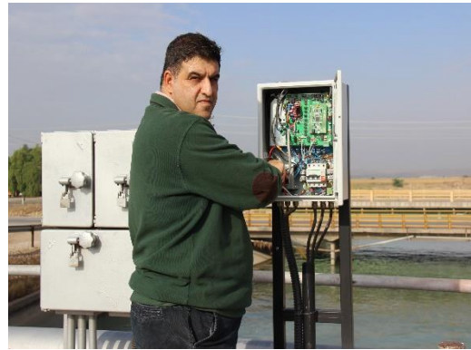
شکل ۱- نمایی از تابلو فرمان سامانه خودکار
